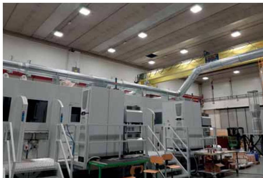
Per l'aspirazione del piano cabina, l'impianto si compone di tubazioni flessibili che dal tetto arrivano al piano calpestio. Il progetto ha previsto tre sistemi di filtrazione Aeris.
